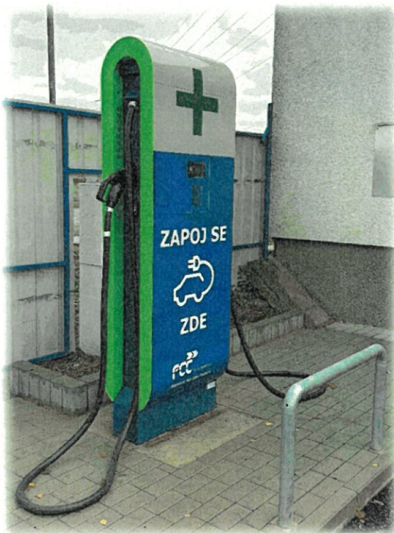
Nabíjecí DC stanice
